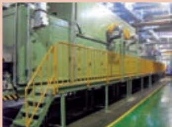
改造された壁紙製造ライン
